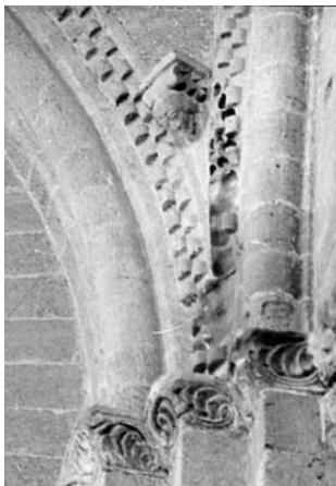
Fig. 4 Ménsula noroeste. Cúpula de la iglesia.
