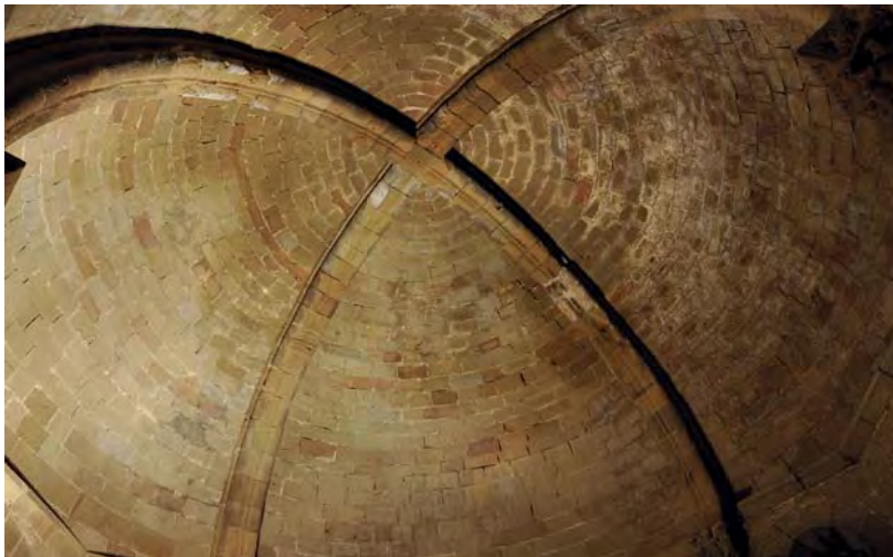
Fig. 12. Bóveda de la sala alta de Santa María de Santa Cruz de la Serós (Foto: autor)
