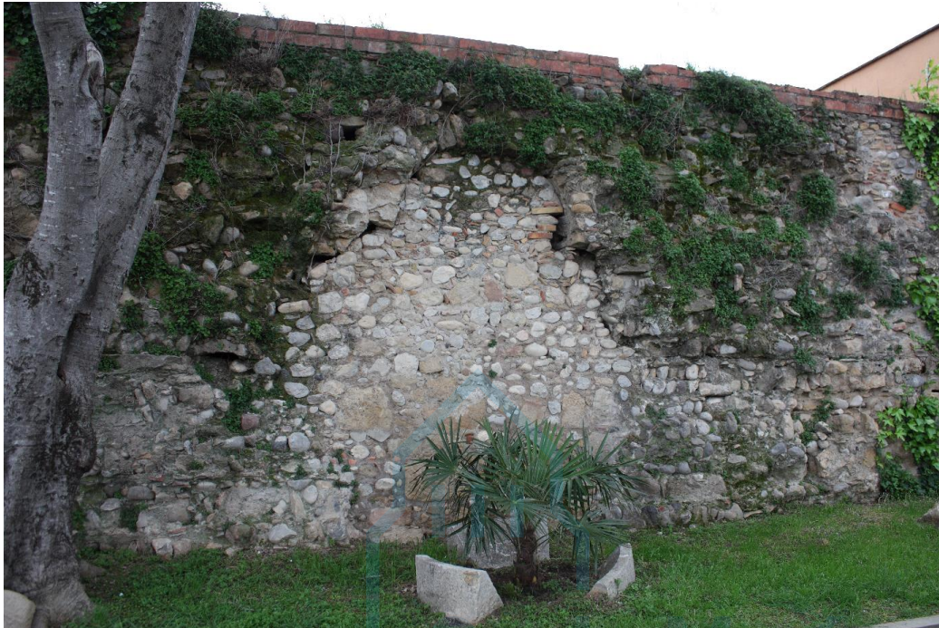
Restos de muro
