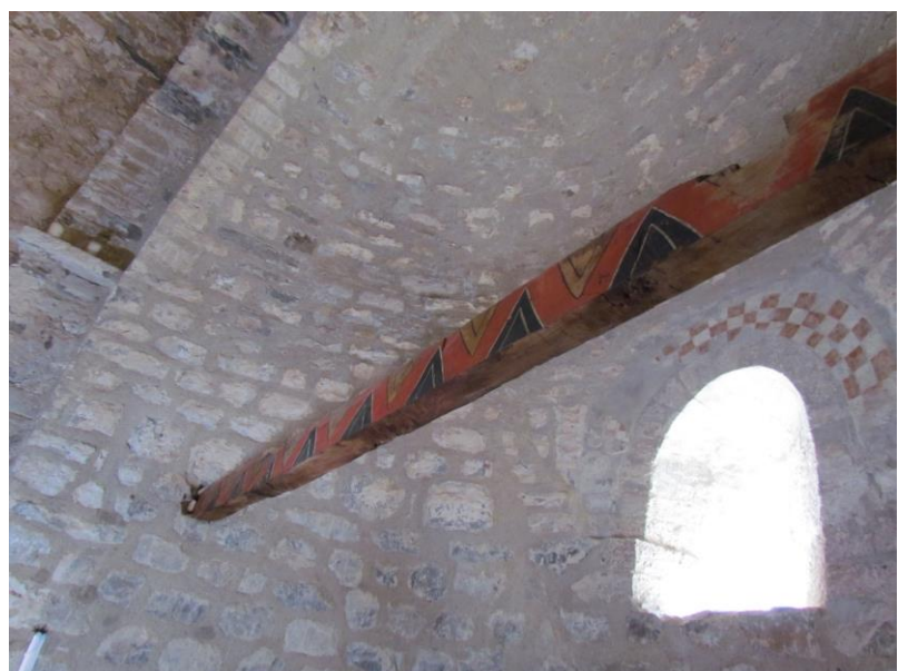
Viga del baldaquino en el ábside y restos de policromía en la ventana
