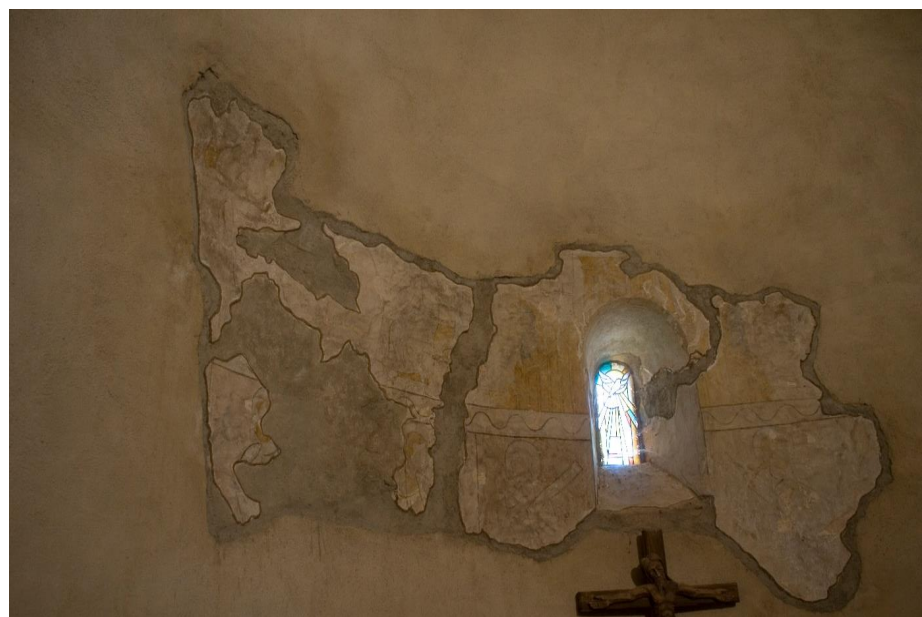
Restos de pintura en el ábside
