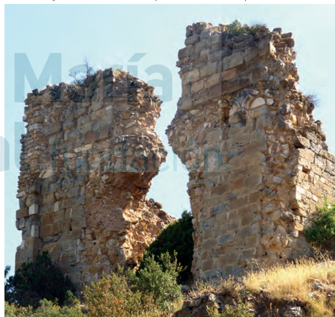
Restos de la fachada occidental en la que estuvo colocada la portada
