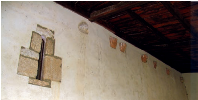
Muro sur. Saetera y restos de canecillos
