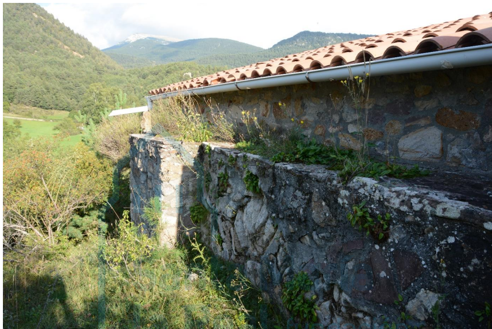
Restos del muro norte
