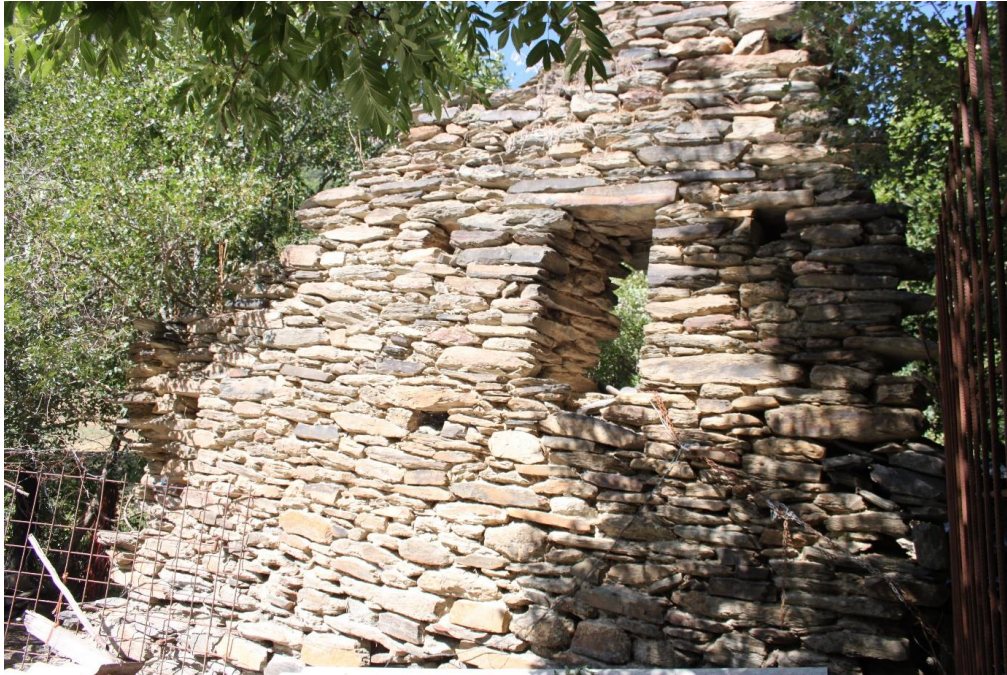
Restos de la fachada occidental
