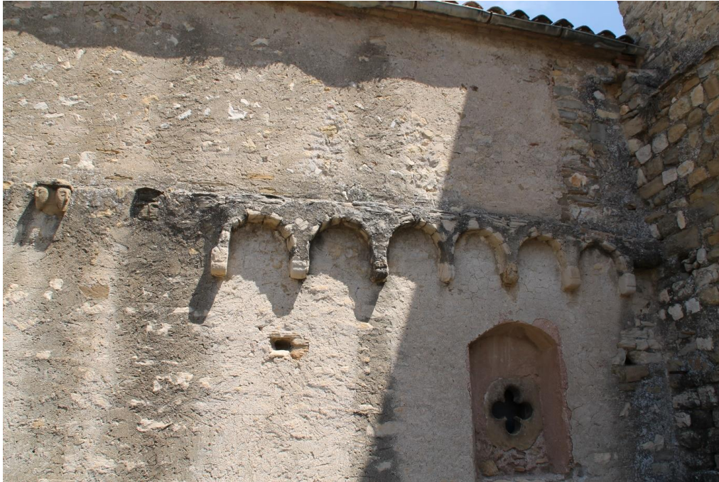
Restos del muro sur
