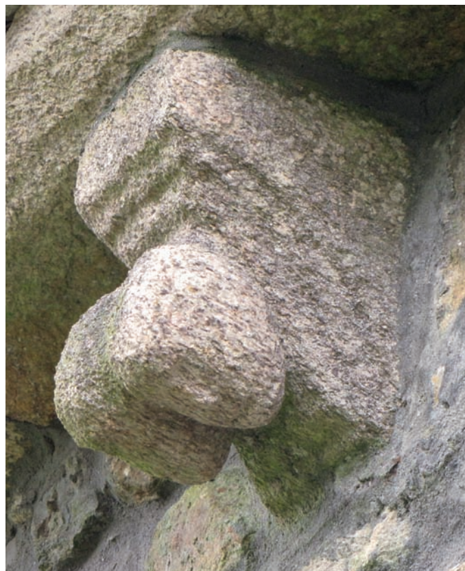
Canecillo del muro norte
