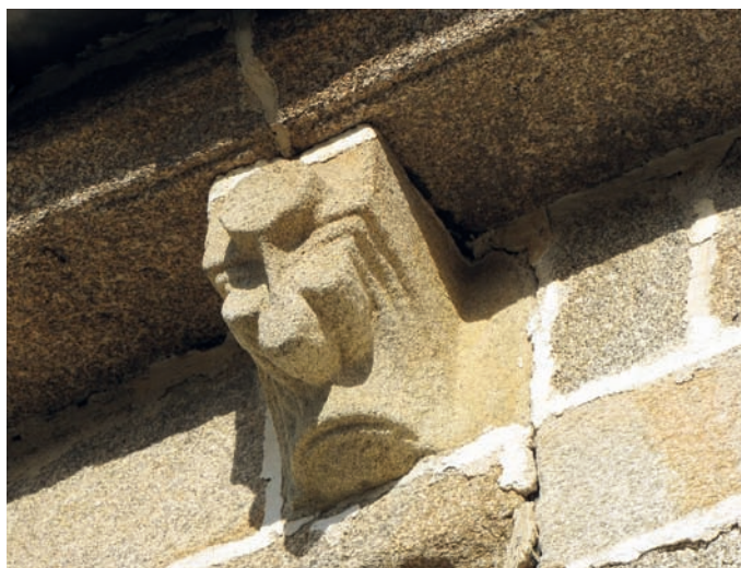
Canecillo del muro sur
