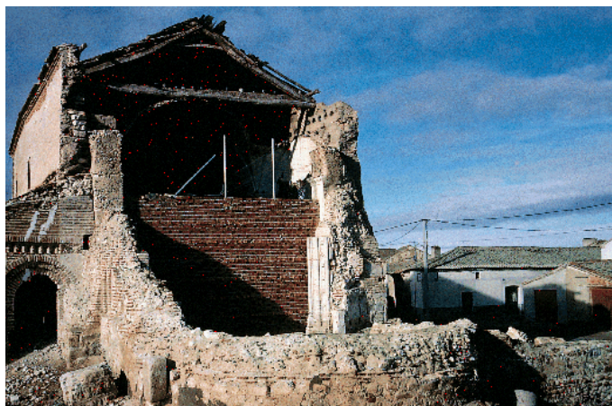
La iglesia tras el derrumbe
