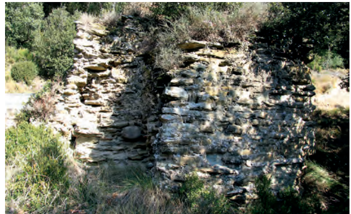
Restos del muro del recinto
