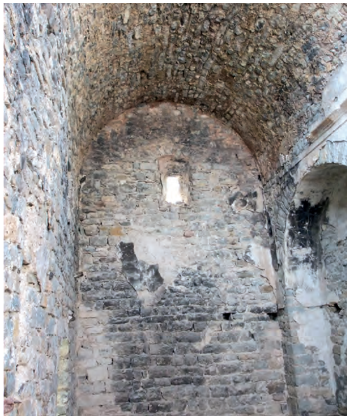
Restos de la bóveda a los pies de la nave
