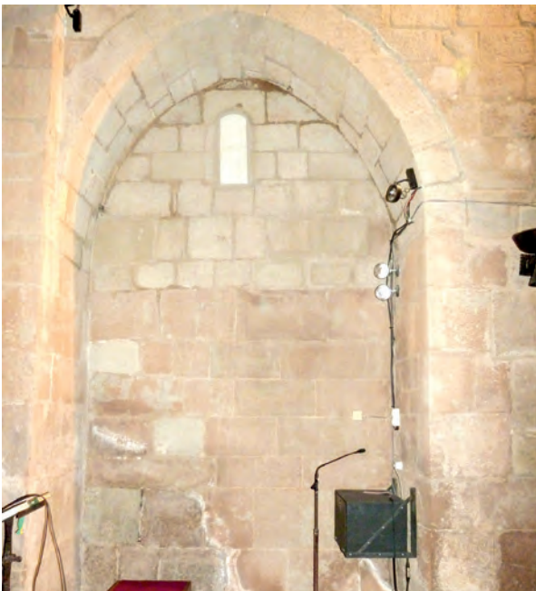
Arcosolio del presbiterio, lado sur, donde se localizaban las pinturas
