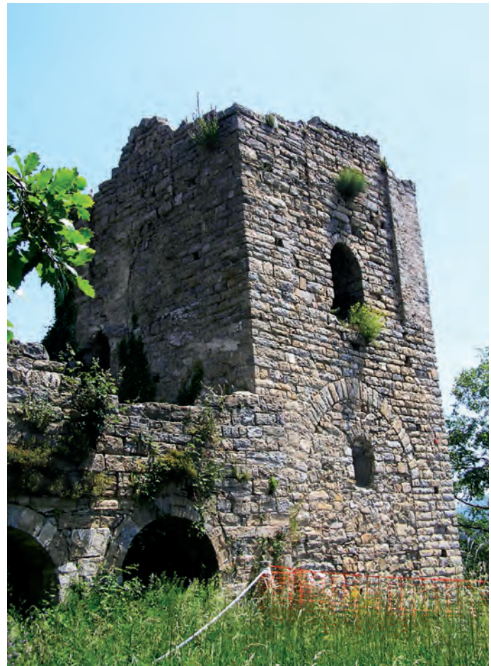
Restos de la torre-campanario
