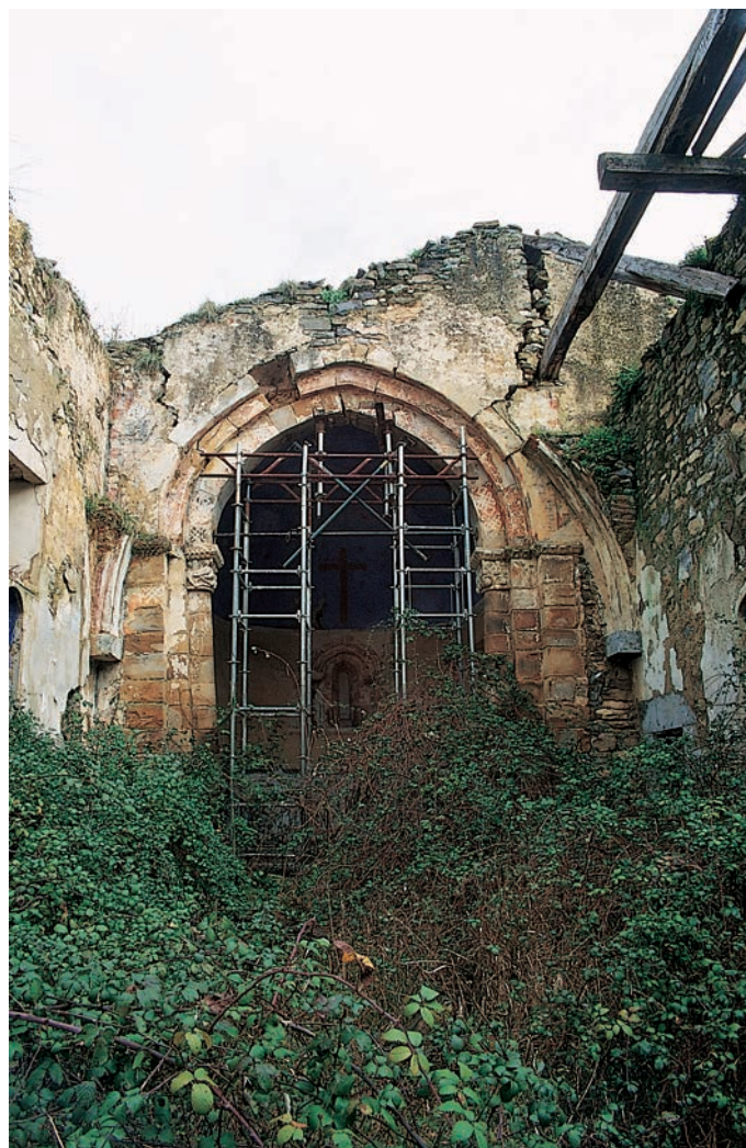
Interior, arruinado e invadido por la vegetación
