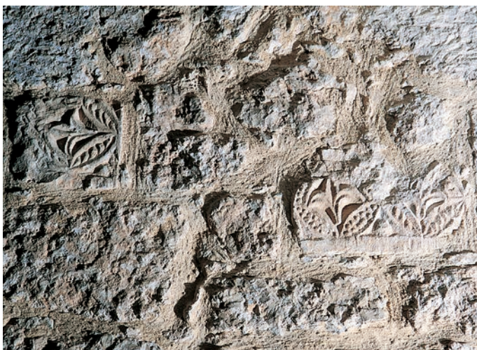
Restos de relieves usados como mampuesto
