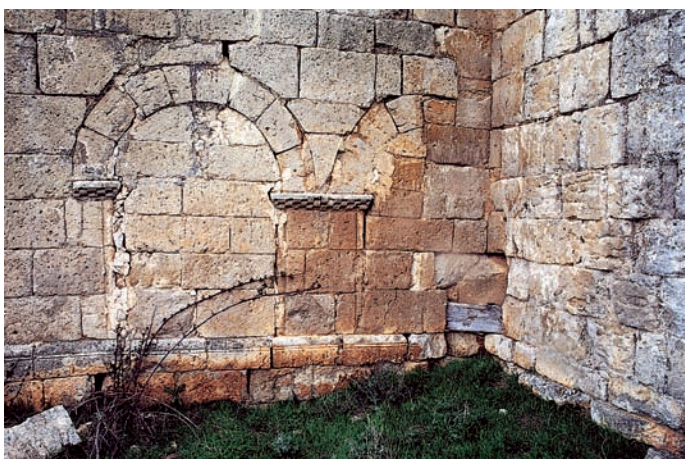
Restos del pórtico románico
