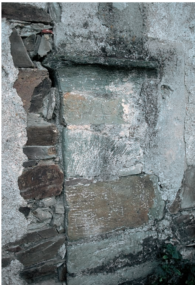
Detalle de la jamba derecha
