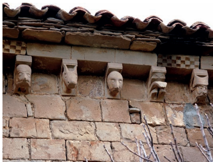
Canecillos del muro sur
