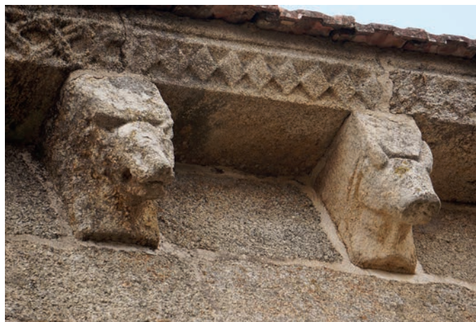
Canecillos del muro sur
