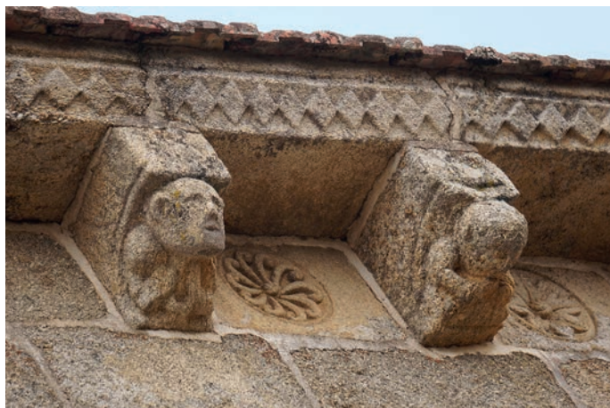
Canecillos del muro sur
