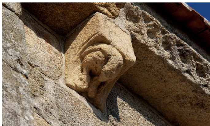
Canecillos del muro sur
