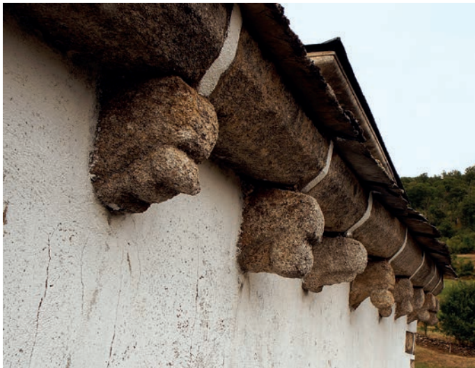
Canecillos del muro sur
