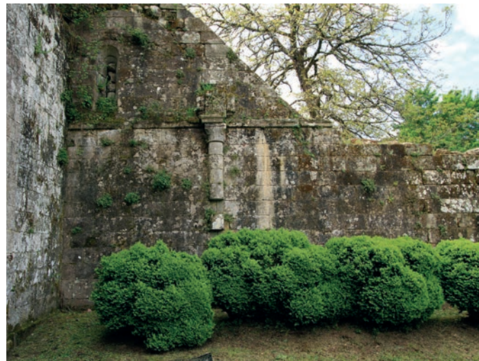
Restos del muro interior de la nave sur
