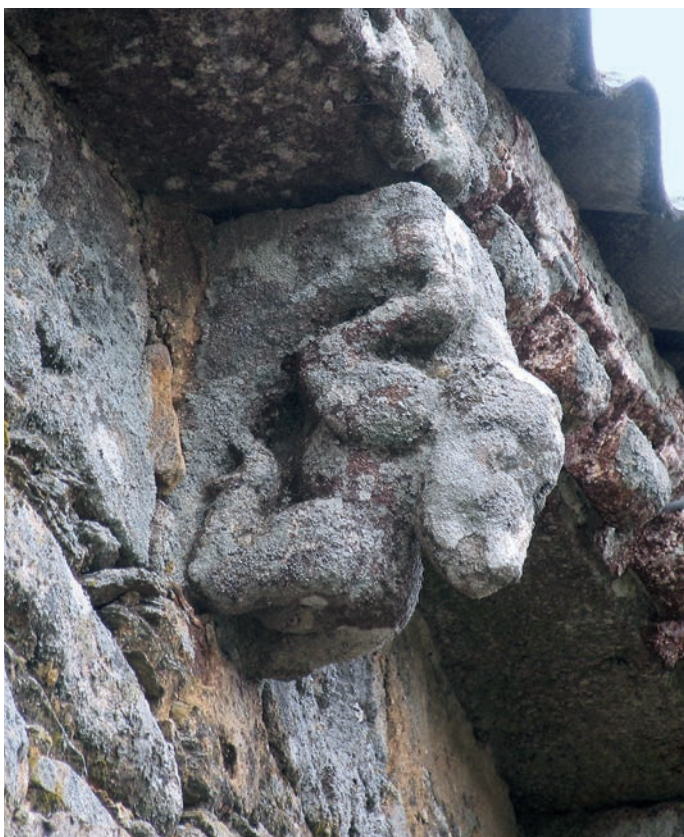
Canecillo del muro sur
