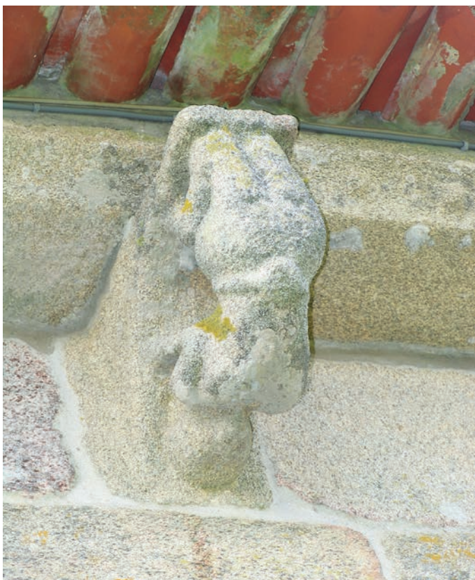
Canecillo del muro sur. Acróbata
