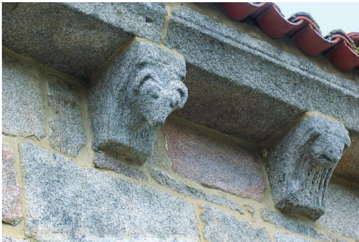
Canecillos del muro sur
