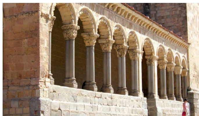
Basamento o zócalo de la galería porticada en la iglesia de San Esteban en Segovia, formado por granitoides, al igual que las basas y los fustes de las columnas
