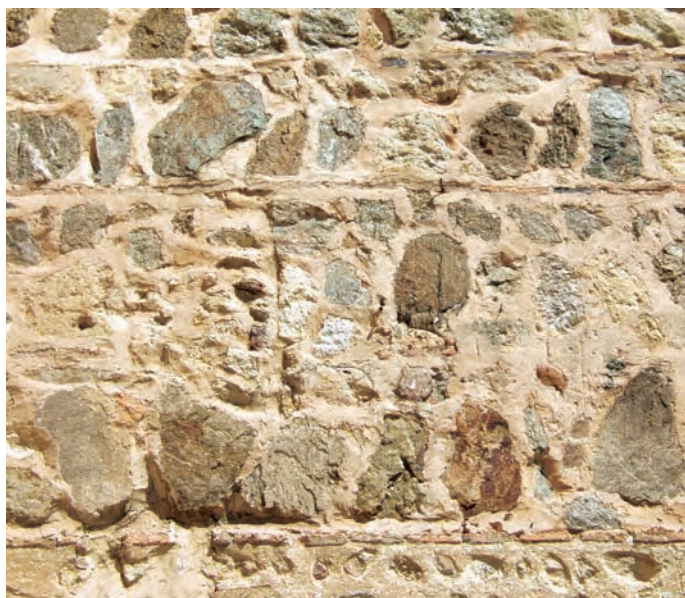
Bloques de rocas metamórficas (gneises y migmatitas) combinados con ladrillos formando un aparejo parecido al toledano, en el cuerpo inferior de la torre de San Andrés de Segovia
