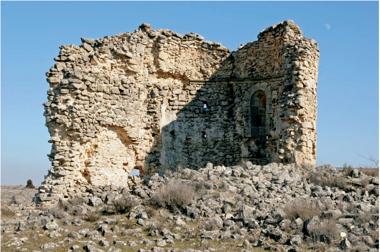
Interior de la arruinada cabecera
