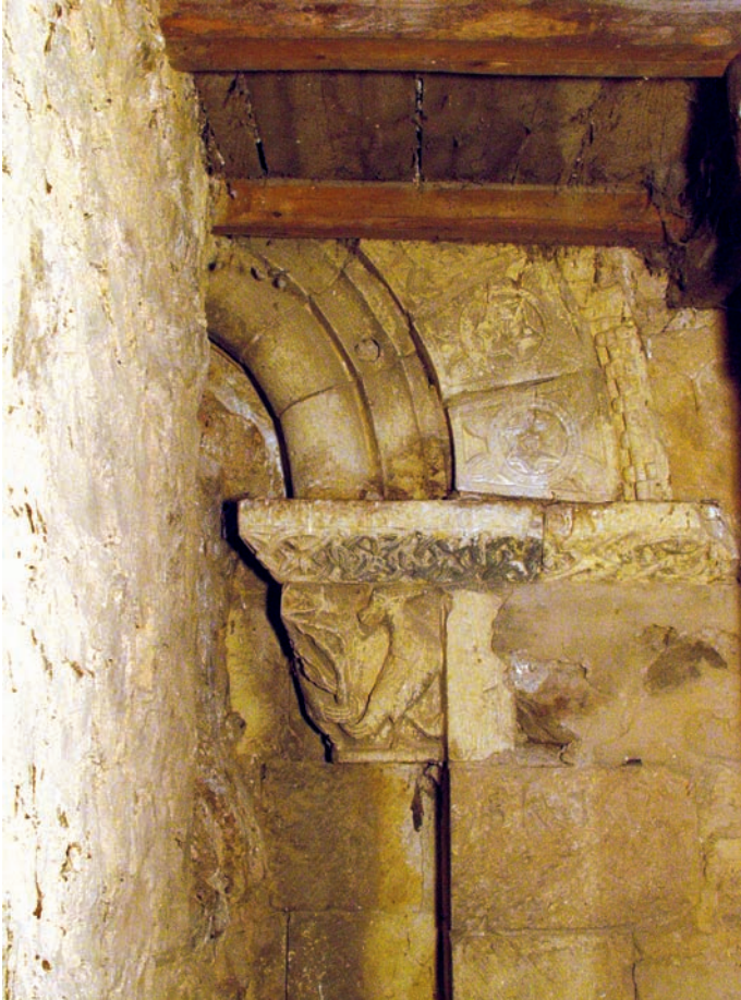
Restos de ventana cegada
